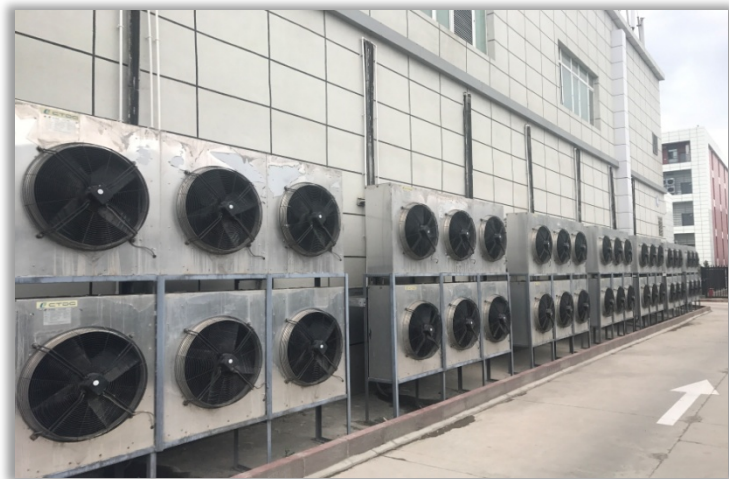
新疆某数据中心
