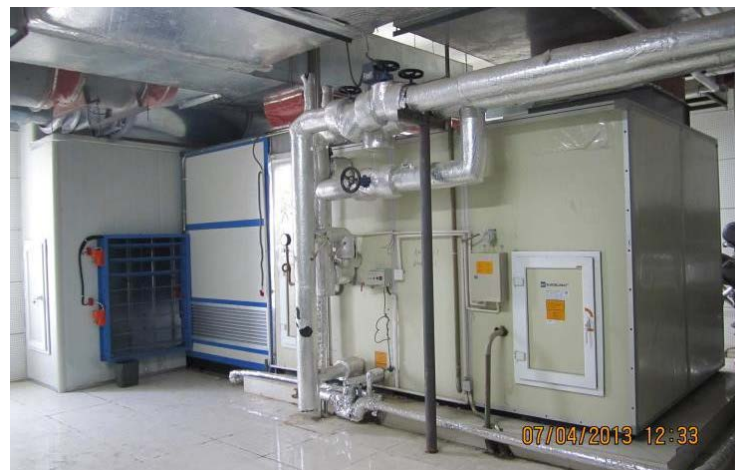
西安某通信机房
